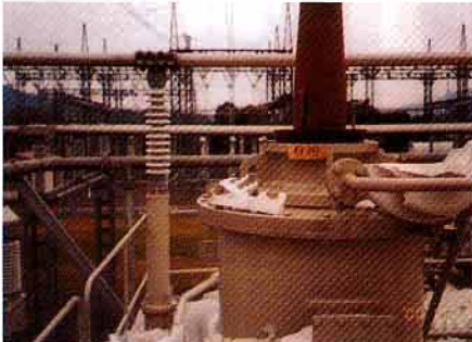
白相 2次ブッシング破損し導体が露出
