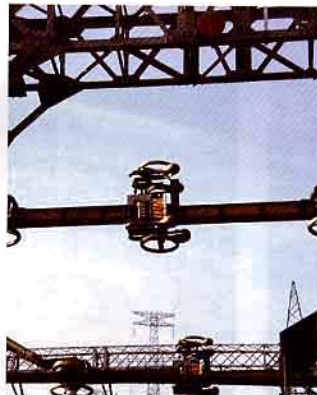
北松江幹線断路器上部振れ止めストッパー破損
