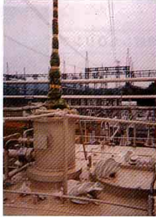
赤相 2次ブッシングの雨水対策後の状況
