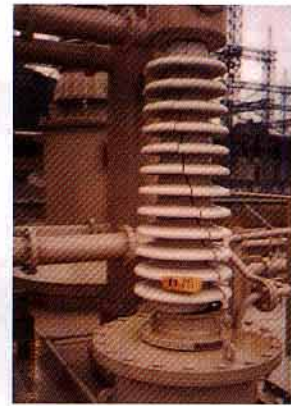
白相中性点ブッシング亀裂損傷
