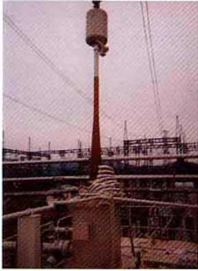
赤相 2次ブッシング破損し導体が露出
