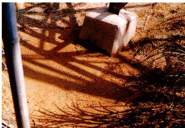
東山反射板 敷地地割れ状況
