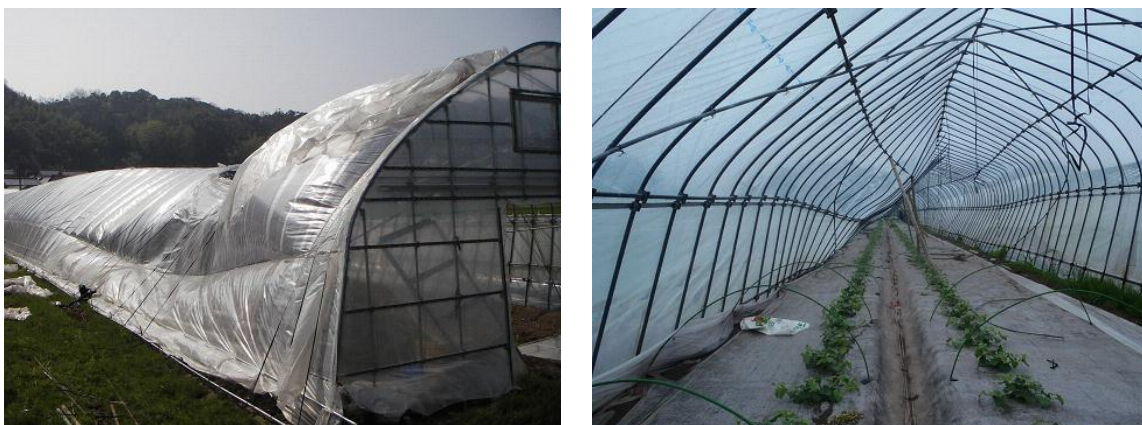
図17 強風によるパイプハウス倒壊事例（鳥取県農業共済組合）
