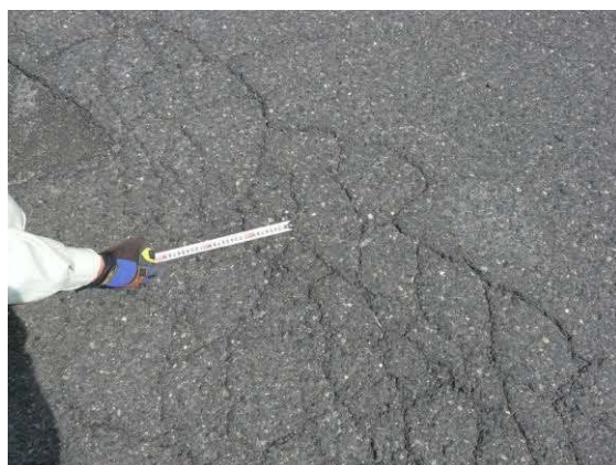
舗装のひびわれ状況
