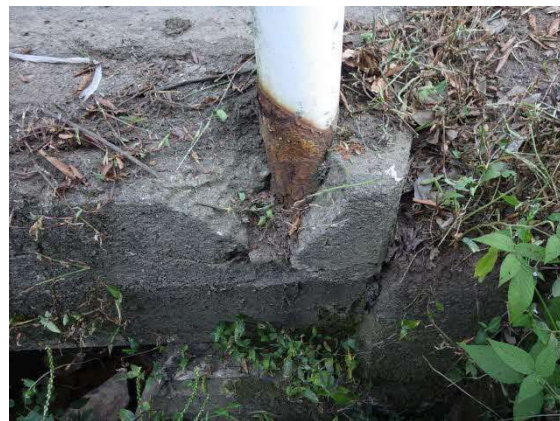
地覆の欠損状況
