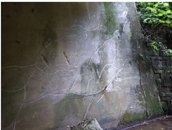
橋台のひびわれ状況
