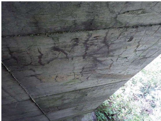
床版下面のひびわれ状況
