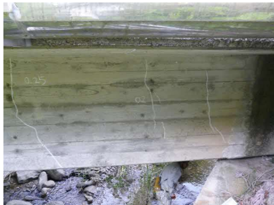
主桁のひびわれ状況
