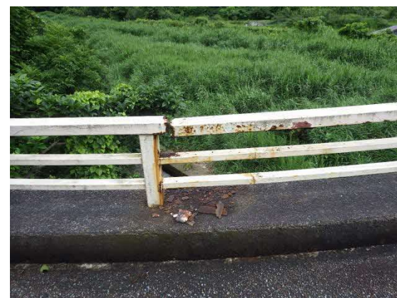
防護柵の破断状況
