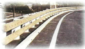
木製ガードレール
