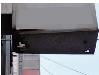
側板底面が腐食、破損、変形した状態
