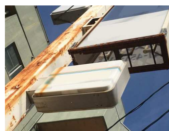
支柱にさびが発生した状態
