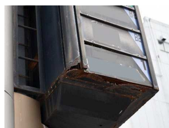
側板底面が腐食、破損した状態
