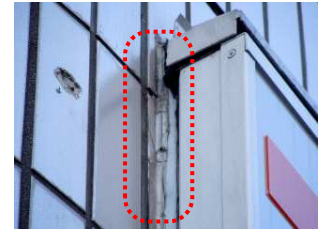
コーキングが劣化した状態
