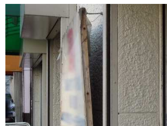
壁面との間に隙間が生じた状態
