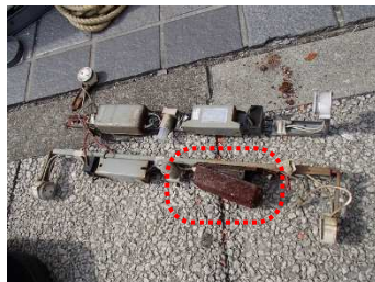
変圧器（トランス）のさびが進行した状態
