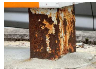
支柱根元の腐食が進行した状態
