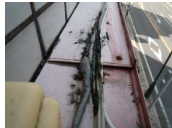
配線が劣化し、ショートした状態
