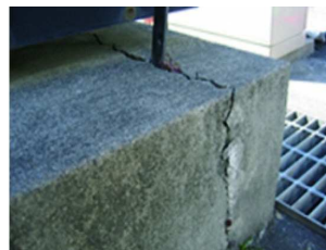
基礎にクラックが入った状態
