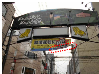
幕材を張る部材が破損した状態
