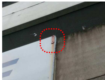
金具が劣化した状態
