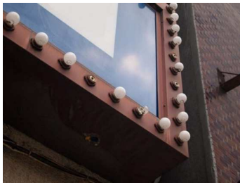
ランプ球が破損した状態
