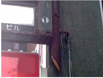
支持部が腐食した状態
