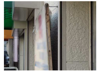
壁面との間に隙間が生じた状態
