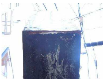
側板底面にさびが発生した状態
