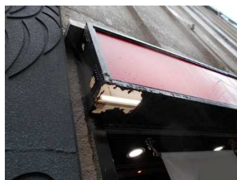
側板底面の腐食が進行した状態
