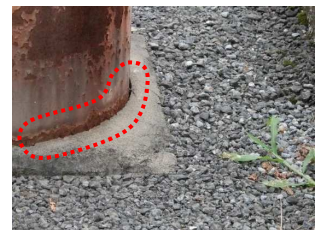
根巻きと支柱との隙間があり、さびが進行した状態
