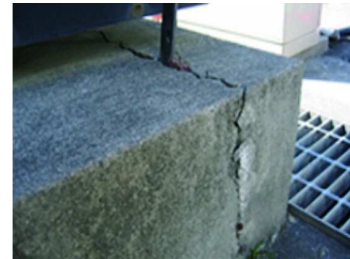
基礎にクラックが入った状態
