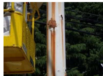
支柱の腐食が進行した状態
