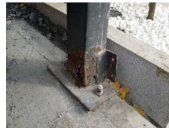
支柱根元の腐食が進行した状態
