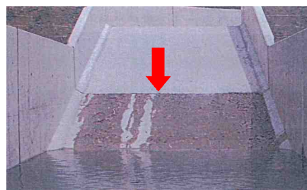
水路打継ぎ目からの漏水【写真-7】
