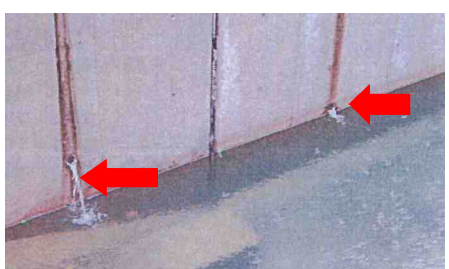
放水路水抜き穴からの漏水【写真-6】
