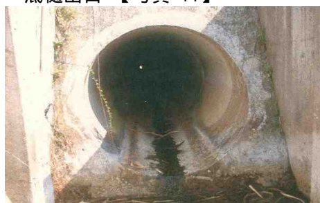
《漏水、不等沈下、破損の有無》
