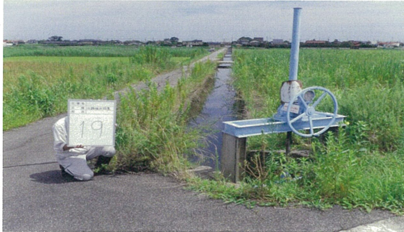
④No.29 管渠出口の土砂堆積状況
