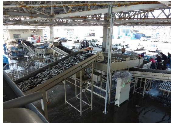
平成23年度に整備された魚体選別機
