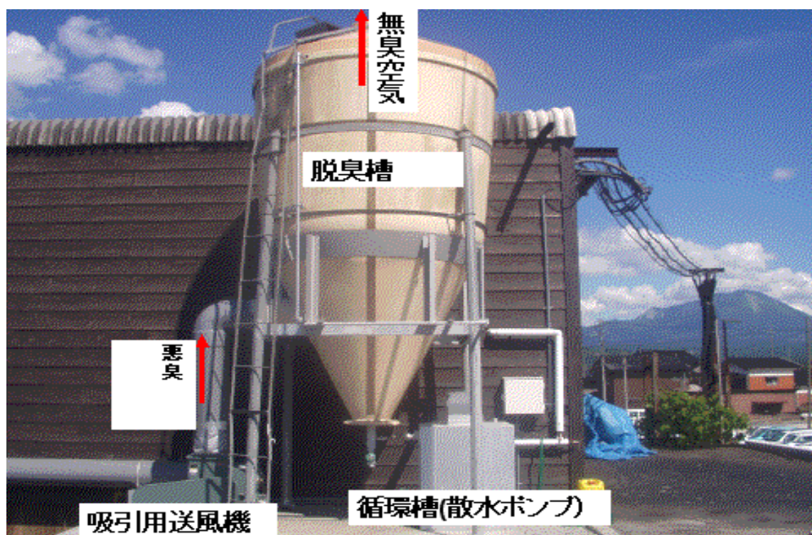
図 1 ガラス発泡材脱臭装置の設置状況
