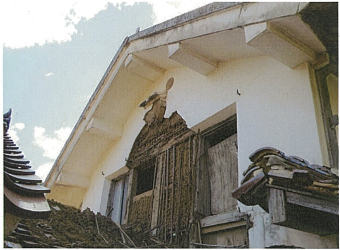
大雨で毀損した門長屋北側妻壁 (平成25年9月末)
