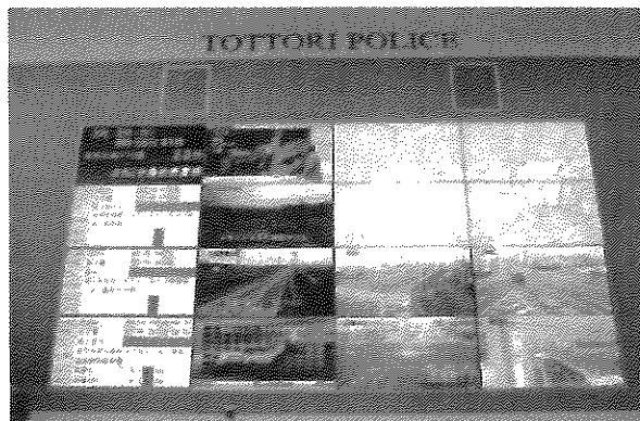
【指令室大型表示装置】
