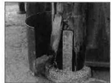
巡視による、腐食の発見
