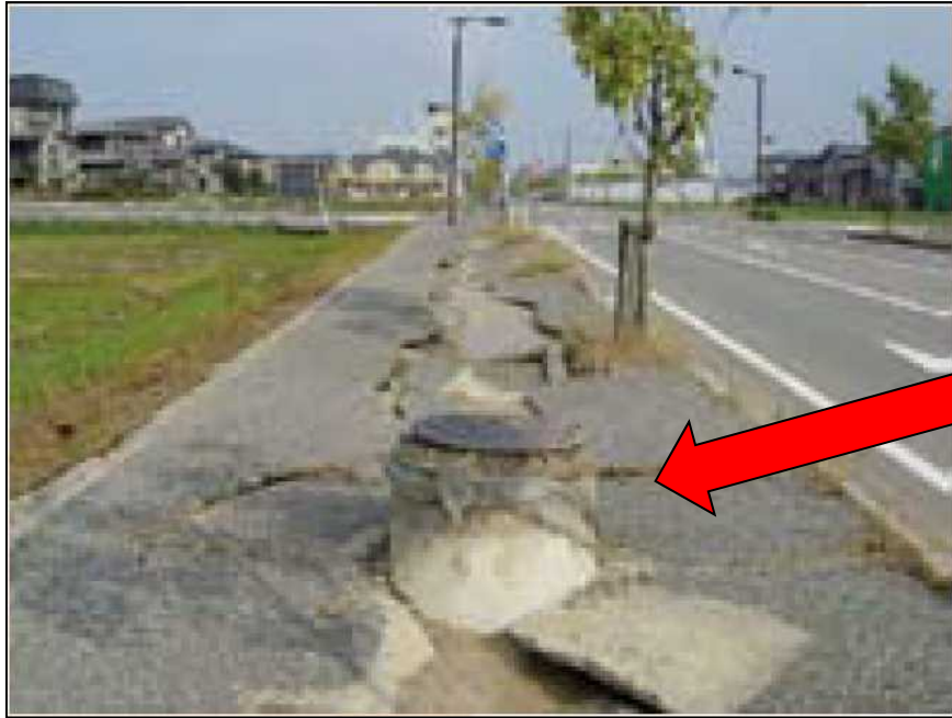
【被害写真：中越地震(平成16年)】
