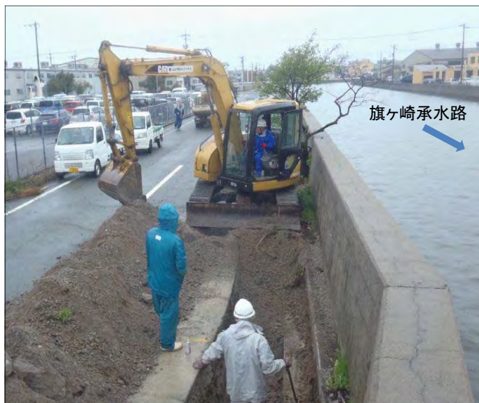
樋門設置工事に着手した、旗ヶ崎承水路の状況（平成26年3月）
