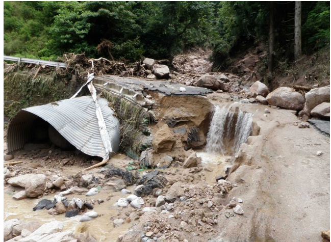
○林道の路体崩壊(県西部:南部町)
