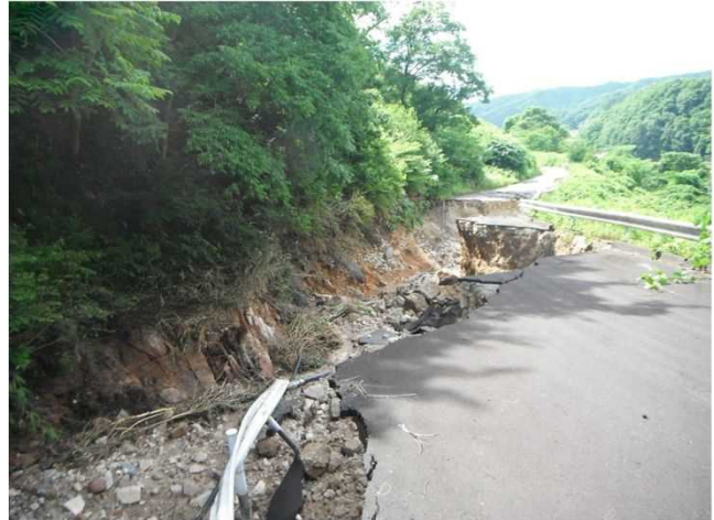
○山からの出水による農道の崩壊(県西部:江府町)
