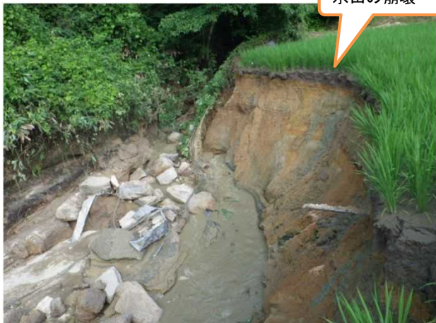
○水路法面の崩壊が水田の畦畔までおよぶ(県西部:南部町)
