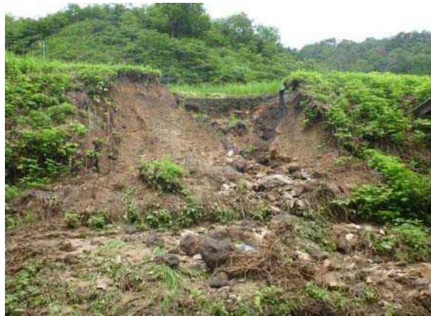
○水田の畦畔崩壊 (三朝町笏賀)
