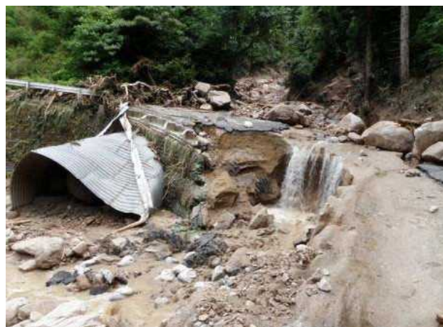
○林道の崩壊 (南部町上中谷)
