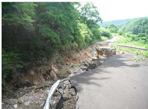
○農道の崩壊 (江府町助沢)
