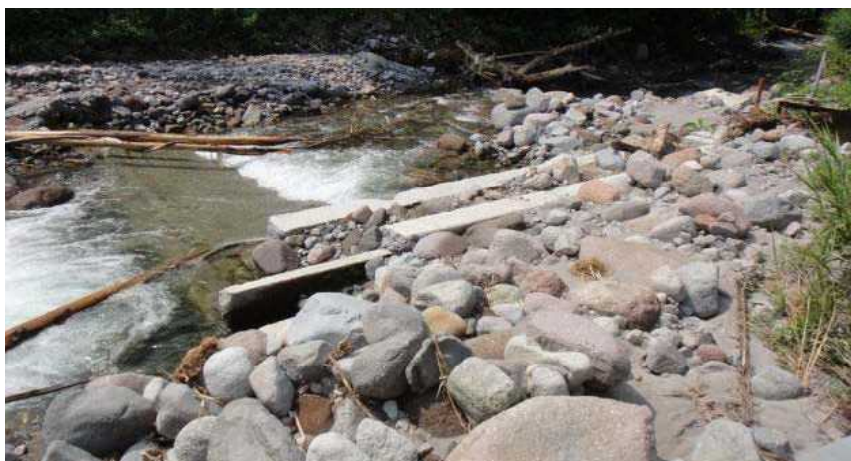
○頭首工が土砂で埋まり、水路が閉塞 (江府町杉谷)
