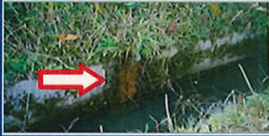
(水路壁の変色)
