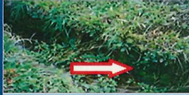
(水路壁全体のにじみ) ④
