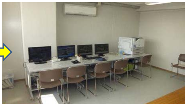
コントロール室内部
