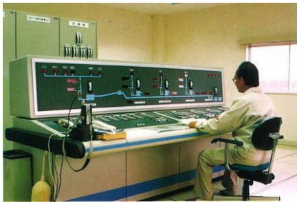
集中監視操作を行う「かん水センター」
