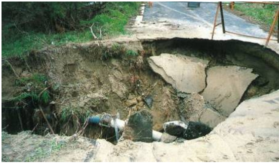
漏水による道路陥没
