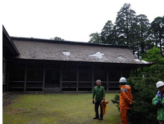
大神山神社拝殿屋根の毀損状況
