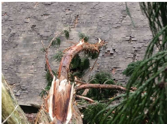
大神山神社本殿屋根の倒木と陥没状況
