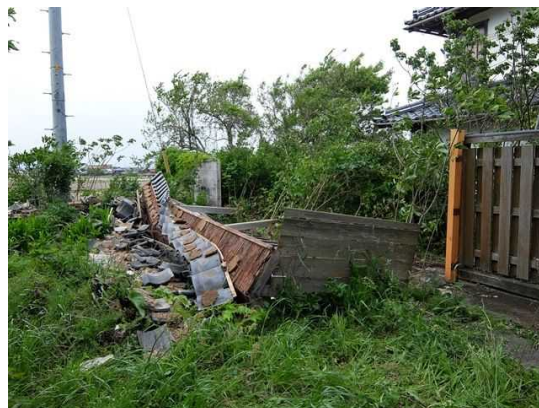
門脇家住宅 倒壊した南塀
