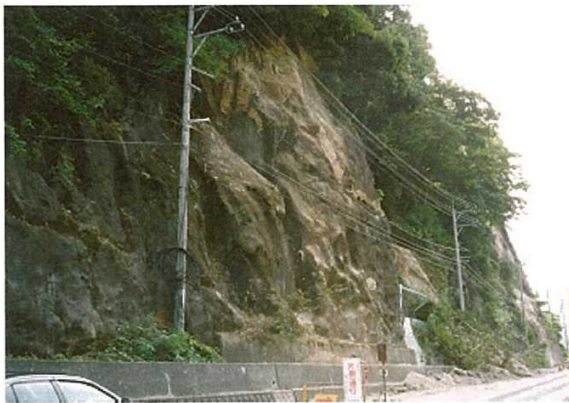
図 8 日野町下黒坂の吹付コンクリート斜面の崩壊（国道 180 号線の南側吹付コンクリート斜面が 3 箇所にわたり崩壊し、コンクリート片および土砂が道路面に落下した）
