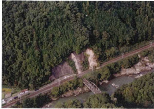
図 6 日野町下黒坂の切土・コンクリート吹付斜面の崩壊（空中写真、地点T14）
