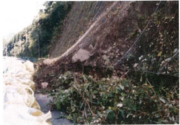
図 9 西伯町大木屋の切土斜面の崩壊（T10、国道 180 号線東側の切土斜面が崩壊したが、落石防止ネットにより道路への飛散が軽減された）
