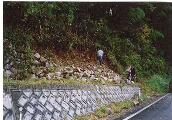
図 15 西伯町赤谷の石積み斜面の崩壊 (高さ 2.5m の石積みが長さ 12m にわたって崩壊した)
