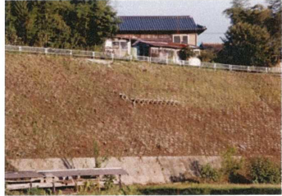
図 13 溝口町古市の河岸段丘崖法面の被害 (T18、河岸段丘崖法面の法枠工の一部が破壊した)
