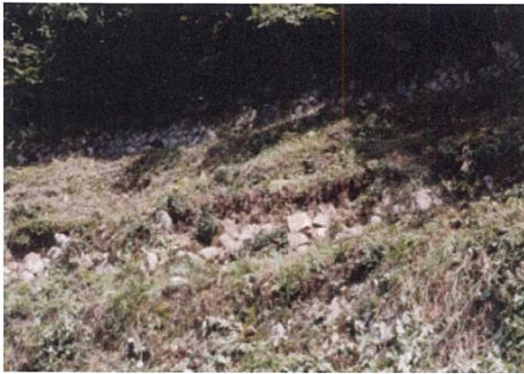
図 14 西伯町赤谷の石積み斜面の崩壊 (T7) (古い石積みが破壊し、多量の落石が生じ、道路面に散乱した)
