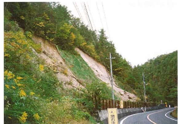
図 11 西伯町井ノ原の切土斜面の崩壊（国道 180 号線西側の切土斜面が崩壊したが、落石防止柵により道路面への被害は出なかった）
