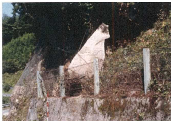
図 10 西伯町赤谷の切土斜面の崩壊（T7、崩落した巨石が擁壁および落石防止柵によって止まり、道路面への被害は出なかった）
