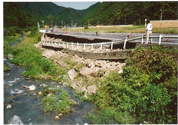
図 21 日野町濁谷の路肩崩壊 (国道 180 号の真住川側の路肩崩壊が高さ約 1.5m、長さ約 50mにわたって崩壊した)
