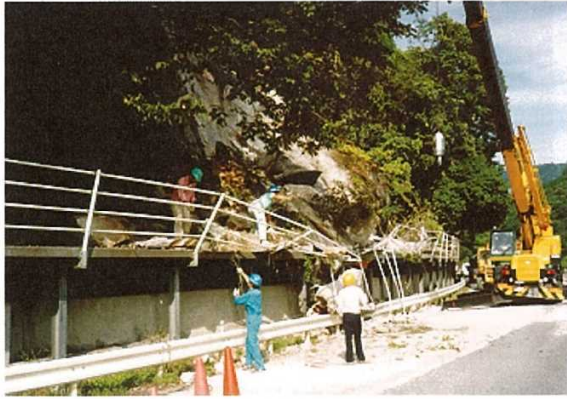
図 12 日野町小河内の吹付コンクリート斜面の崩壊(国道 180 号線北側の吹付コンクリート斜面が岩盤崩壊したが、落石防止柵によって被害が軽減された)
